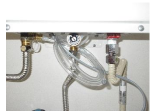
給湯器の水抜栓
