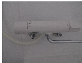
浴室水栓の水抜栓
